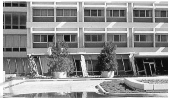
شکل ۲) ایجاد طبقه نرم در بیمارستان البیویو در زلزله ۱۹۷۱ سان‌فرانسیسکو در اثر حذف دیوارهای برشی طبقه همکف [1]
