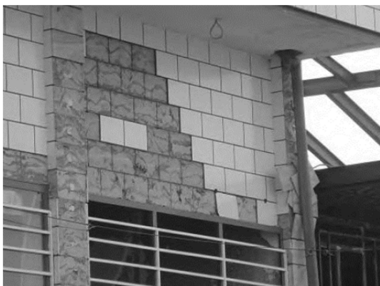
شکل ۶) فروریختن سنگ‌های پلاک به دلیل عدم استفاده از پیچ و رول پلاک یا اسکوپ [25]
