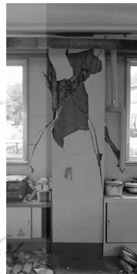
شکل ۱۱) شکست ستون و دیوارهای مجاور به دلیل بتن‌ریزی همزمان؛ زلزله ۲۰۱۱ توهاکو ژاپن [33]
