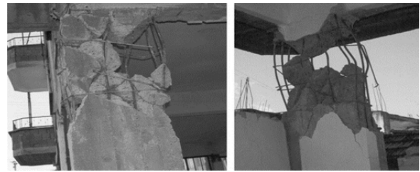
شکل ۱۰) شکست به دلیل فواصل زیادی خاموت‌ها در ستون [17]
