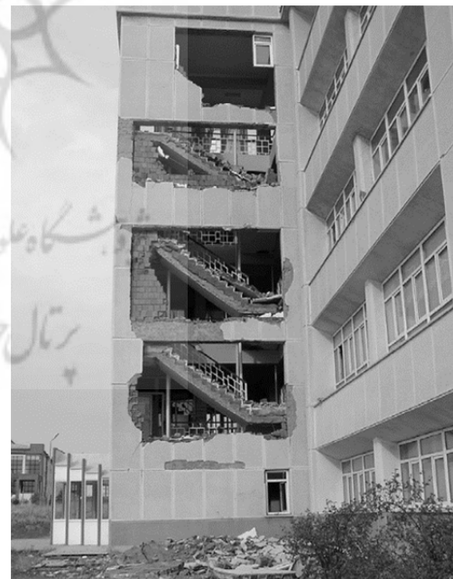
شکل ۸) خسارت وارده به دیوار و سازه پله؛ زلزله ۲۰۱۱ وان ترکیه [18]
