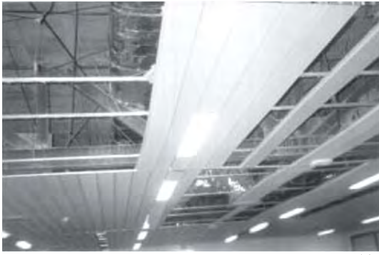
شکل ۹) فروریختن پنل‌های سقف کاذب؛ زلزله ۱۳۸۲ بم [24]
