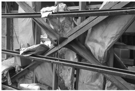
شکل ۱۲) کمانش پیچشی جانبی در محل تقاطع مهاربندی: زلزله ۲۰۱۱ توهاکو ژاپن [33]
