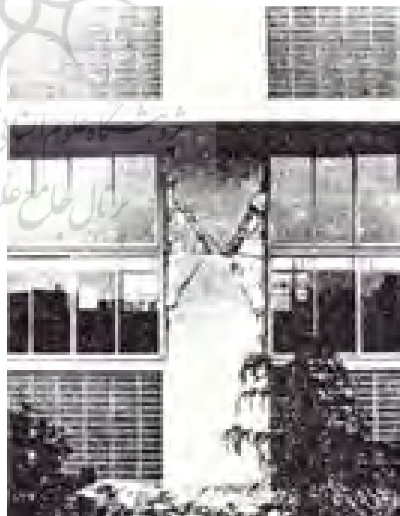
تصویر ۶: شکست برشی ستون کوتاه در زلزله ۱۹۶۸ تاکاچی اوکی ژاپن [۲۸]
