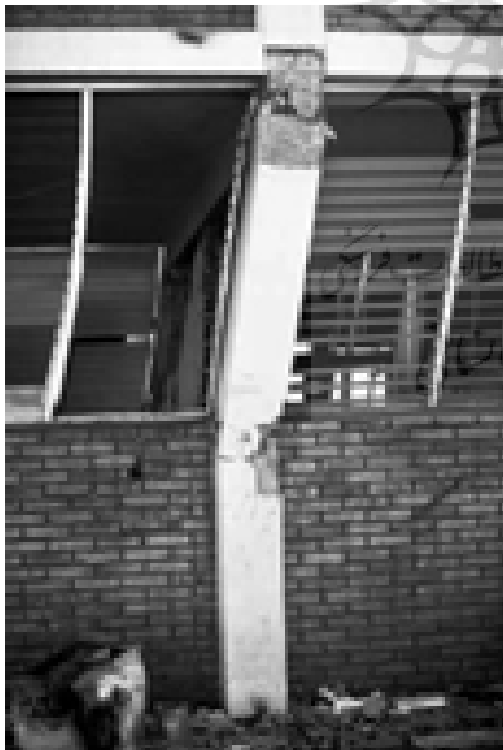
تصویر ۷: شکست خمشی ستون کوتاه [۲۹]
