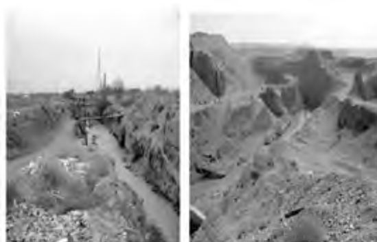
نگاره ۲: وضعیت انباشت زباله و فاضلاب در مسیل کن قبل از شروع عملیات اجرایی باز توسعه
