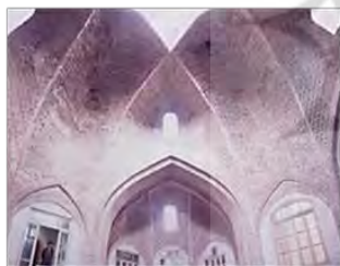
تصویر ۱۷: گنبد با باریکه طاق‌های باربر مقطع از تیمچه حاج شیخ کاظم بازار تبریز. (حاجی قاسمی، ۱۳۷۵، ۱۳۲). و نمای زیر گنبد تیمچه حاج شیخ کاظم. (حاجی قاسمی، ۱۳۷۵، ۱۳۲).
