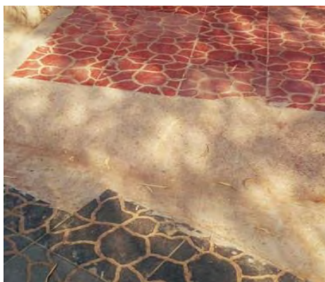
شکل ۳. اتصال نامناسب کفسازی ها
