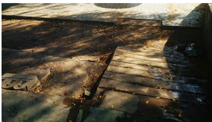
شکل ۴. کفسازی های کنده شده و نامناسب
