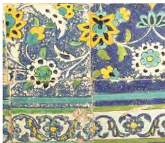
تصویر ۱۴. نمونه‌ای از کاشی تخریب شده و در حال تخریب به علت کیفیت ساخت پایین (منبع: نگارندگان)
