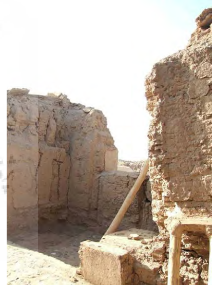
تصویر ۳: الف. ورودی مسدود شده قدیمی پس از زلزله ۱۳۸۲
