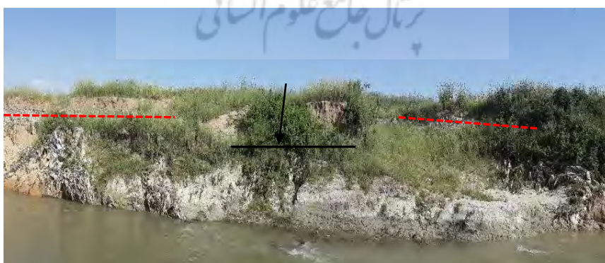
شکل ۲۰: محل عبور گسل از رودخانه خرمآباد در محدوده دشت در طول 48^{\circ}17' شرقی و عرض 33^{\circ}27' شمالی. قطع شدگی لایه رسوبات رودخانه‌ای بر روی رسوبات ریزدانه و تغییر رنگ و نوع رسوبات در محل عبور گسل مشخص است (دید به سمت شرق) تهیه و ترسیم: نگارندگان، ۱۳۹۷
