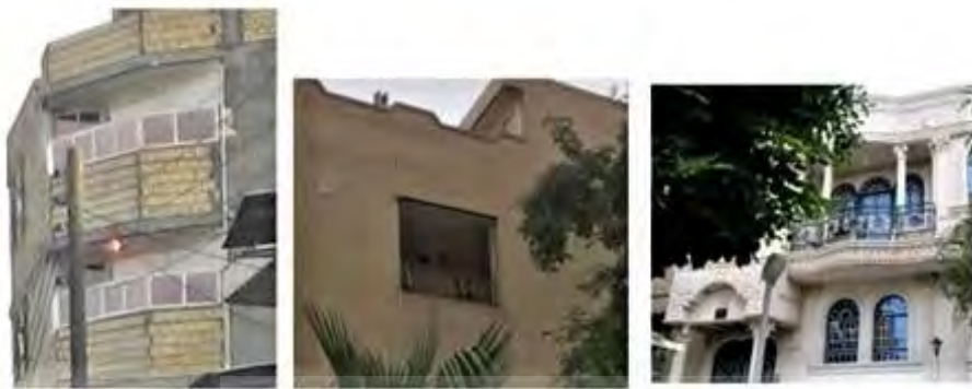
شکل شماره ۴: نمایی از پنجره و سایبان ساختمان‌های شهر ماهشهر (عکس از: نگارنده)
