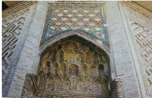
تصویر ۲: گرگان، امامزاده اسحاق، تزئینات بدنه خارجی بنا و استفاده از کاشی فیروزه‌ای (حاجی قاسمی، ۱۳۸۹)
