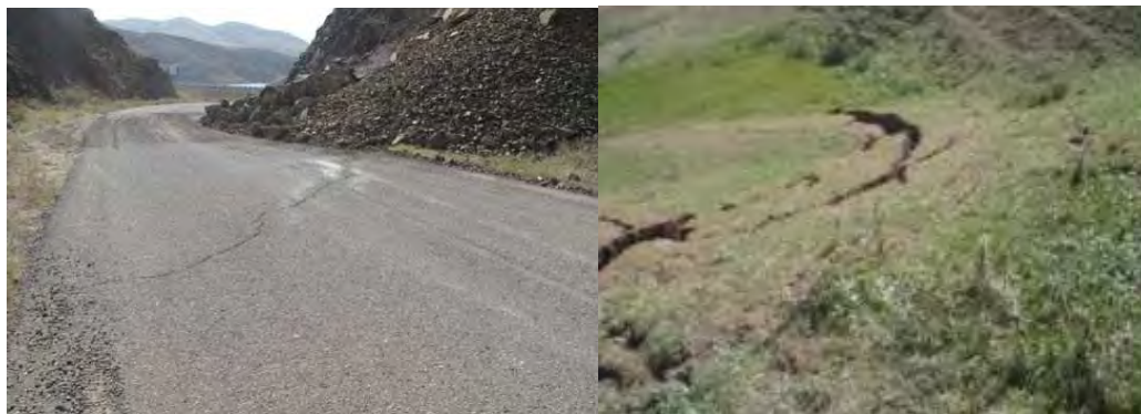
شکل ۵: لغزش بلوکی خاکی در ۳ کیلومتری شمال شرق روستای چوپانلار و سنگ لغزش در جاده سد ستارخان اهر
