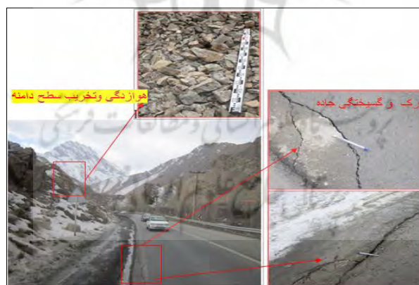
شکل ۱۰ تخریب و گسیختگی سطوح جاده و سنگ‌های دامنه‌ای
