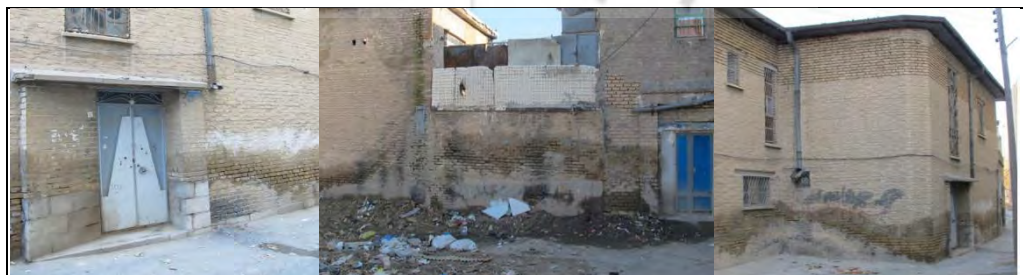
شکل شماره (۴): رطوبت نزولی و عدم صحیح (استفاده از ناودان)
