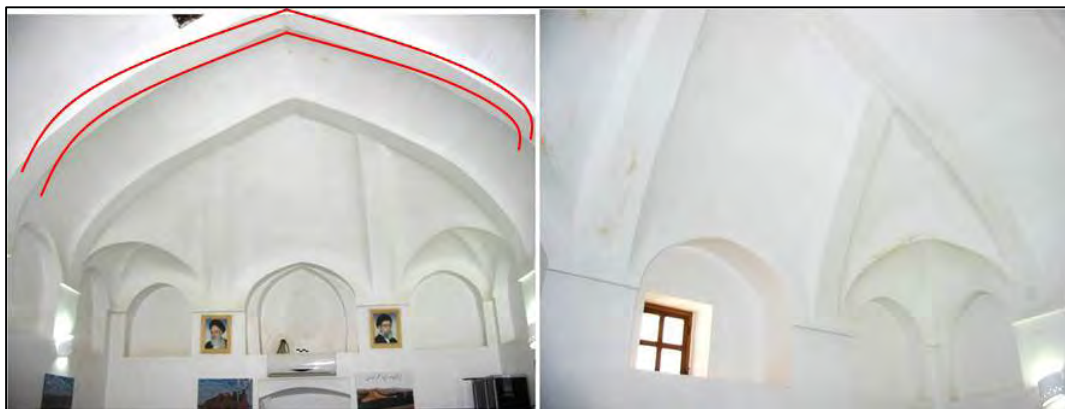
تصویر ۹: راست: گوشه سازی اسکنج چپ: پوشش طاق و تویزه اتاق میهمان در ضلع شمالی (نگارندگان، ۱۳۹۴)
