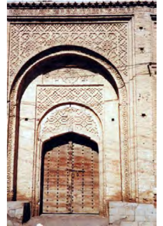
تصویر ۱۰: خانه زرگر محله قلعه شماره ثبت ۷۹۰۱. این ورودی به عنوان پرکارترین ورودی در بافت دزفول و مربوط به دوره قاجار می باشد.
