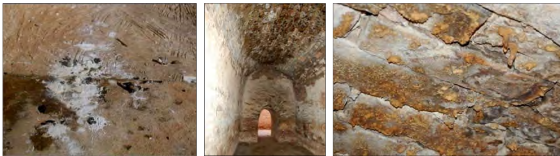
شکل ۱۶: تجمع فضله‌ی خفاش‌ها بر روی آجرهای طاق آرامگاه شماره ۵ مجموعه‌ی میراث جهانی چغازنبیل (پیرک، پاییز ۱۳۹۰) و لکه‌های حاصل از فضله‌ی پرندگان بر روی سنگ‌های ضلع جنوب شرقی آرامگاه کوروش، مجموعه‌ی میراث جهانی پاسارگاد (پیرک، زمستان ۱۳۸۳).
