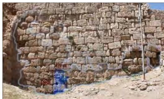
شکل ۹: محدوده‌ی افزایش رطوبت ناشی از نشت فاضلاب سرویس بهداشتی. باروی شماره‌ی ۲ مجموعه‌ی جهانی تخت سلیمان (پیرک، بهار ۱۳۸۹).
