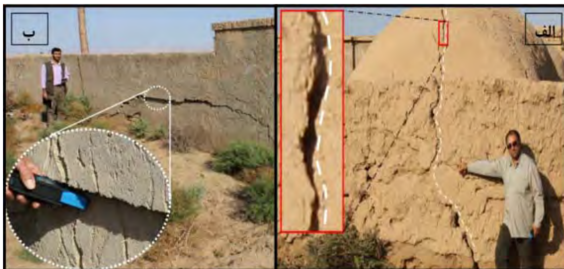
شکل ۱۰- ایجاد گسیختگی در سازه‌های انسان‌ساز: الف) ایجاد ترک عمود بر سازه به علت قرارگیری در لبه فرونشست. ب) ایجاد ترک افقی بر بدنه دیوار به علت قرارگیری در مرکز هسته فرونشست
