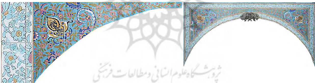
شکل ۱۶. راست: کاشی کاری پشت بغل قوس بالا سردر / چپ: جزئیات کاشی کاری پشت بغل قوس بالای سردر (مأخذ: نگارندگان)
