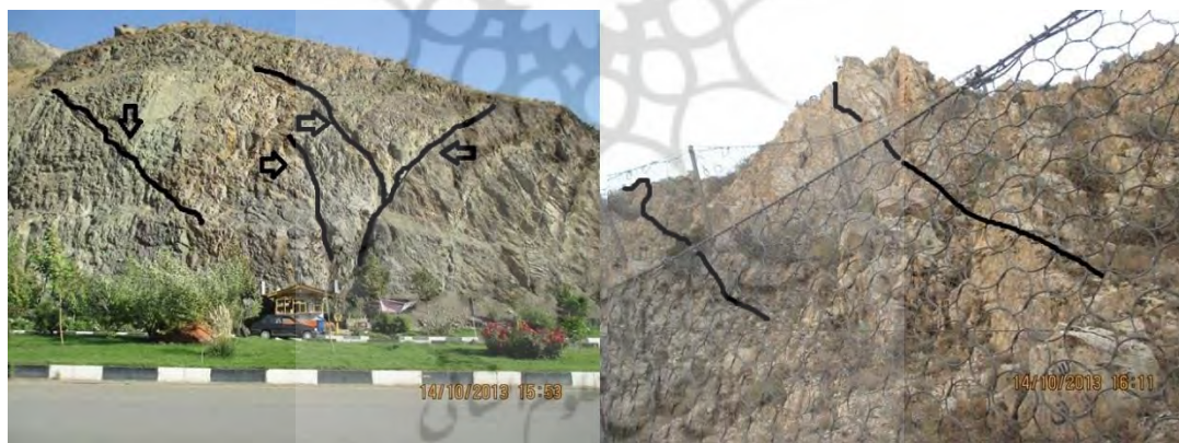
شکل ۲. گسل خوردگی بر روی سنگ‌های مقاوم (سمت چپ) و سنگ‌های خردشده و گسل خورده بر روی دامنه همراه با سازه‌های محافظتی ژئوتکستال (سمت راست)
