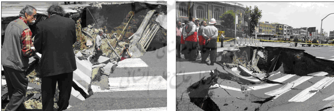
شکل ۷. فروریزی بخشی از یک قنات
