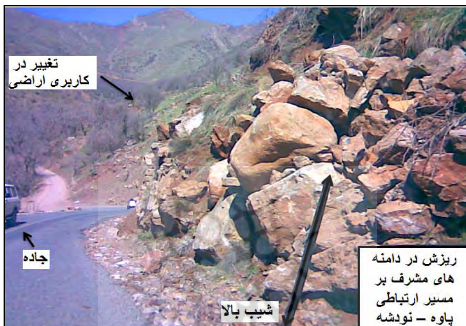
شکل ۱. نمونه‌ای از ریزش رخ داده در مسیر ارتباطی پاوه - نودشه
