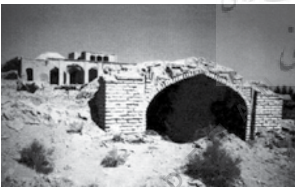
تصویر شماره ۱۱: سال ۱۳۷۸ سردر ورودی حمام و آسیب‌های وارده، در پس زمینه تصویر طبقه اول جبهه جنوب شرقی اصطلاحاً شرقی عمارت دیده می‌شود.
