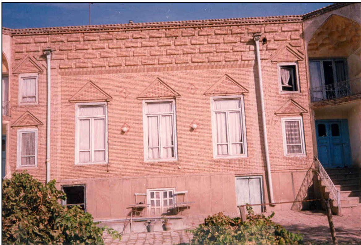
تصویر ۳. تصویر نمای خانه بهنام که در آن پنجره‌های اوری حذف و به پنجره کوچکتر تبدیل شده است (آرشیو دانشکده معماری و شهرسازی دانشگاه هنر اسلامی تبریز)
