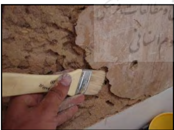
شکل ۲۵. تخریب لایه آستر توسط موربانه و جدا شدن بستر
