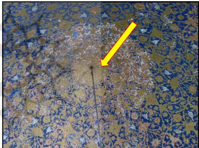
تصویر ۳: بخش مرکزی سقف گنبد که دارای کتیبه است، قبل از مرمت
