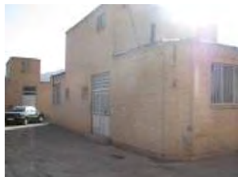
شکل (۵) نمایی از ساختمان‌های آجری بدون شناژ (واحد ۳)
