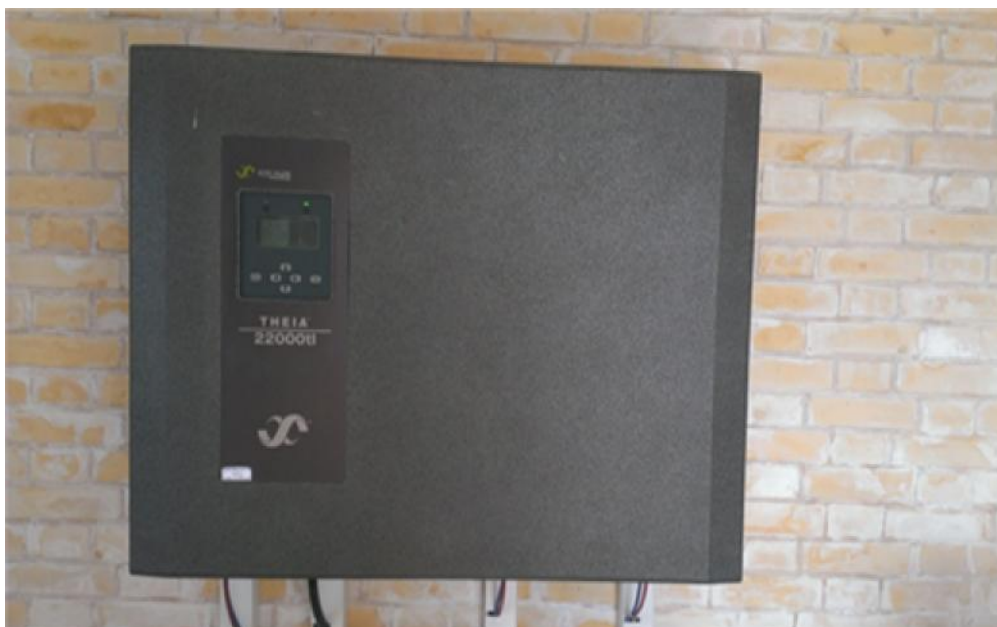
شکل ۶) اینورتر سیستم مانیتورینگ نیروگاه دانشگاه یزد
