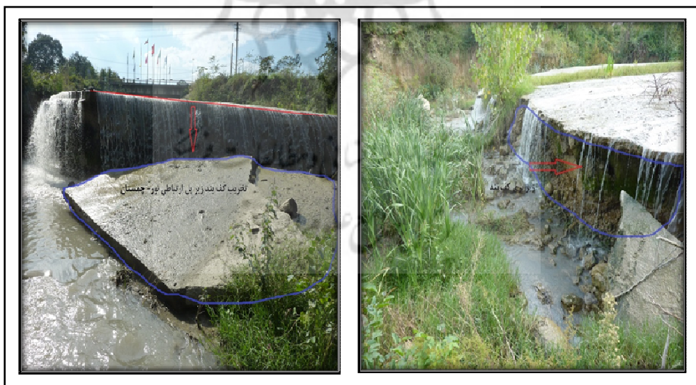
شکل ۹ تخریب آبشارهای کوتاه احداث شده در بستر رود برای جلوگیری از فرسایش بستر
