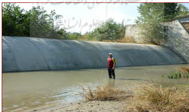
شکل ۳ شکستگی بستر رود و احداث آبشار کوچک بر روی آن
