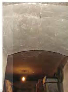
تصویر ۱۰: ایجاد ترک در پوشش زیرزمین - بهمن ۱۳۸۸
