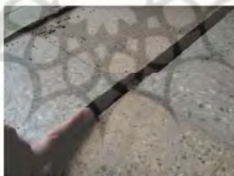
تصویر ۱۱: ترک پوشش زیرزمین در طبقه اول - بهمن ۱۳۸۸
