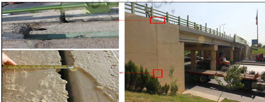
شکل شماره ۶: تصویری از ایجاد درز و شکاف در پل بزرگراه آیت الله سعیدی ناشی از پدیده فرونشست (عکس: نگارنده)
