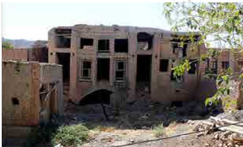
تصویر شماره ۶: مهم ترین عامل در آسیب پذیری بناهای تاریخی و به ویژه تک بناهای شاخص در معرض زلزله، وجود ناپایداری و آسیب های سازه ای قبلی در این بناهاست که در اولین گام، نیازمند اقدامات استحکام بخشی هستند. (خانه تاریخی در ذراق (استان مرکزی) - ماخذ: آرشیو تصاویر نگارنده).
