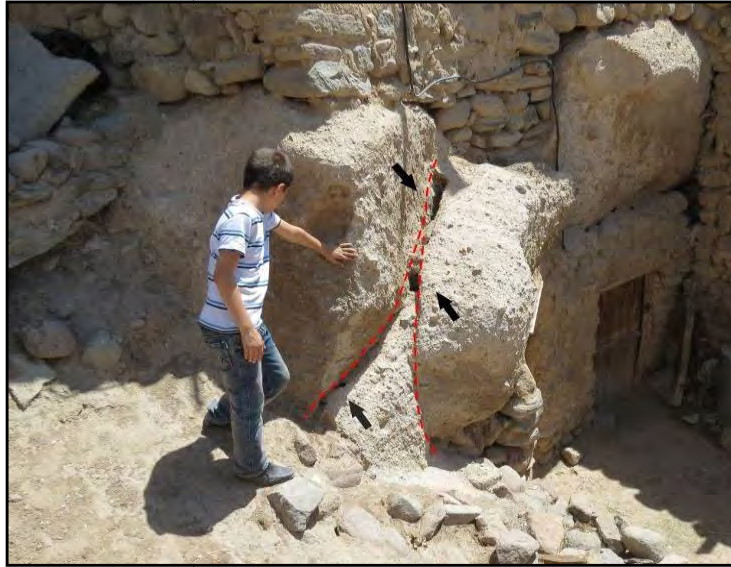
تصویر ۵۰: نفوذ آب در امتداد شکستگی‌ها به داخل توده سنگ
