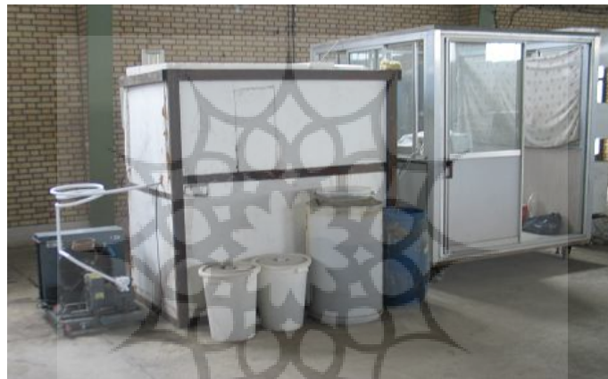
شکل ۲- نمای کلی سیستم گرمایش-تبرید همراه با اتاقک کنترل آن
