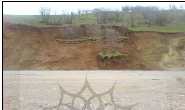
شکل ۹: لغزش توده سست (سارند گوری) در اثر تخریب سطح اتکای دامنه در اثر اعمال مکانیکی احداث جاده
