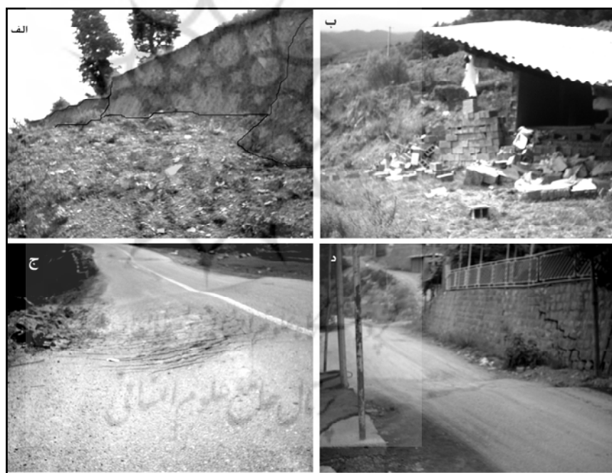
شکل ۱: نمای برخی حرکات زمین‌لغزه‌ای در منطقه چلاو.
