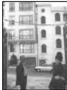
شکل شماره ۵- نشست ساختمان در اثر عبور کاریز از زیر آن، سعادت آباد، بلوار فرهنگ، خیابان ۲۸
