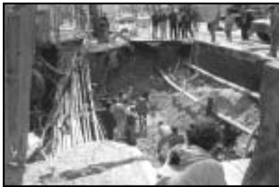
شکل شماره ۶- فروریزی بخشی از خیابان ولی عصر (طول ۲۰، عرض ۸ و عمق ۶ متر) مابین میدان ونک و پارک ساعی به علت فروریزی بخشی از گالری کاریز متروکه
