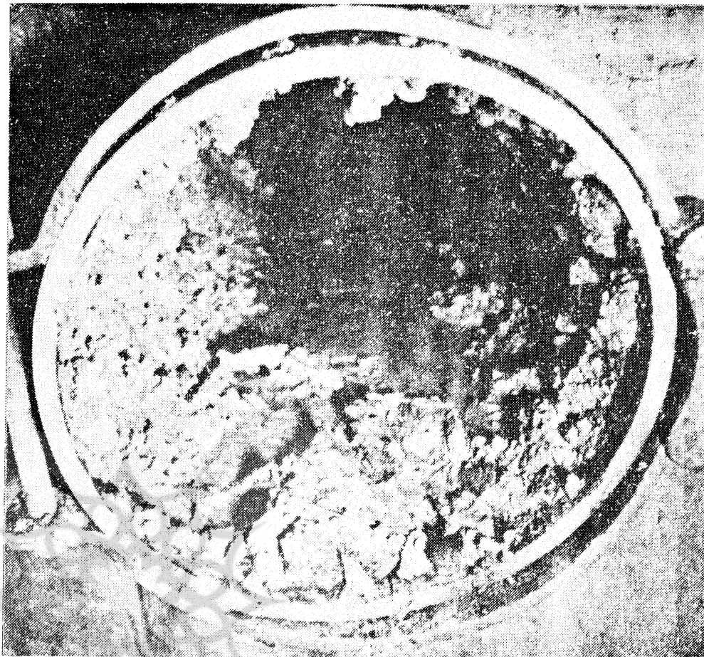
خوردگی فعال باعث ایجاد فرورفتگی و سوراخ در سطح داخلی لوله می گردد
