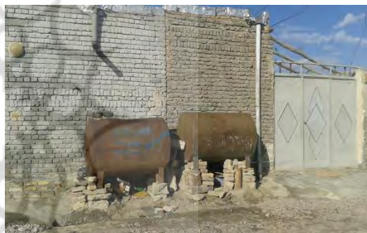
شکل ۲- احداث واحدهای مسکونی بدون رعایت معیارهای فنی (منبع: نگارنده)
