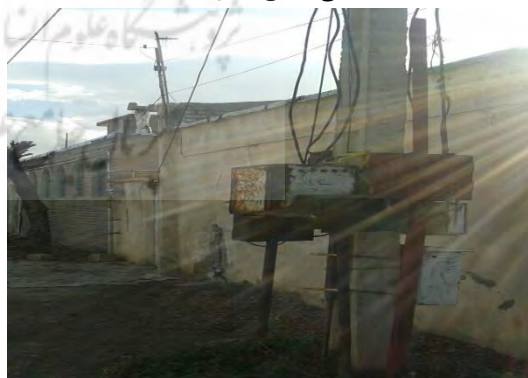
شکل شماره ۴- استفاده از برق غیر مجاز (منبع: نگارنده)
