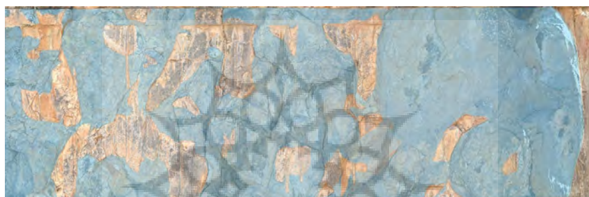
آسیب نگاری بلوک شماره ۴، آسیب فرسایش (EROSION)
