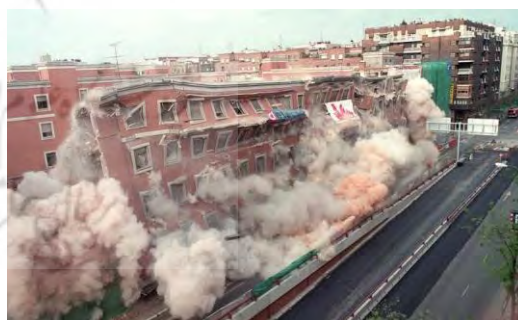
شکل ۲. تخریب یک بنای درمانی در اثر انفجار (Bouza et al, 2002, 235)
