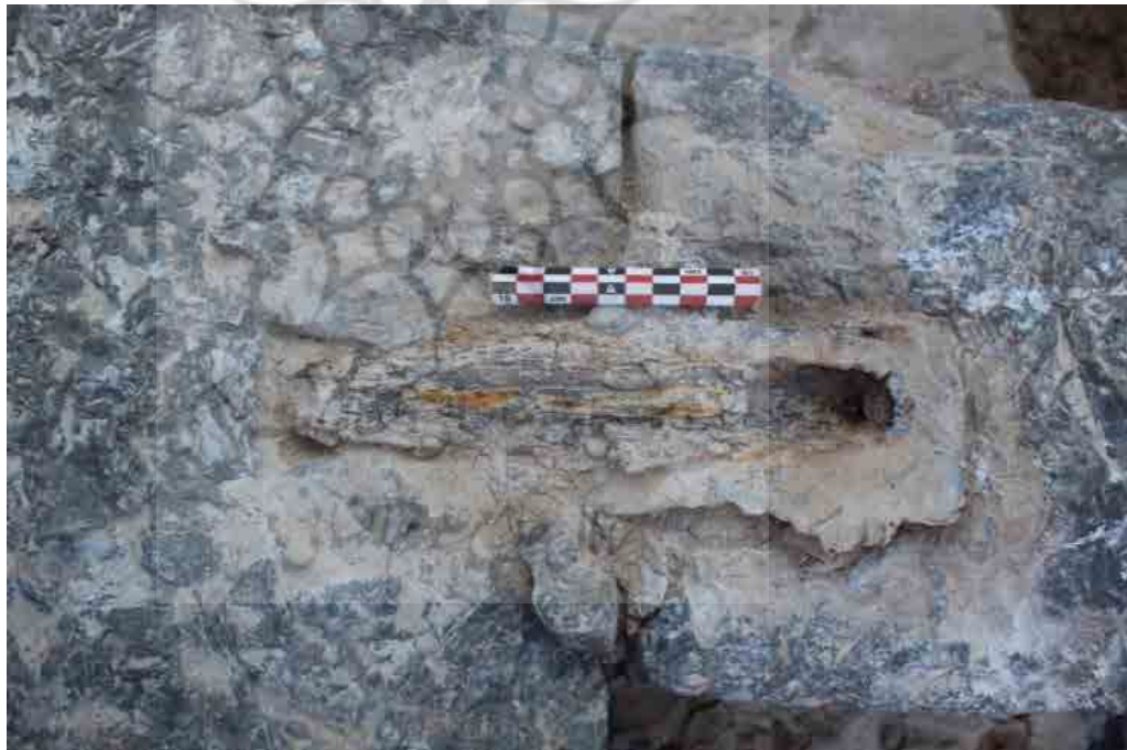
شکل ۳۸. گیره سالم آهنی با پوشش سربی به کار رفته در سازه معماری درون هسته سد دیدگان (کرمی، ۱۳۹۹). Fig. 38. Iron clamp with lead coating used in the architectural structure inside the core of Didegan Dam (Karami, 2019).
