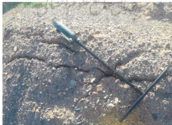
شکل ۱۲. ترک های کششی سطح باطله ها
