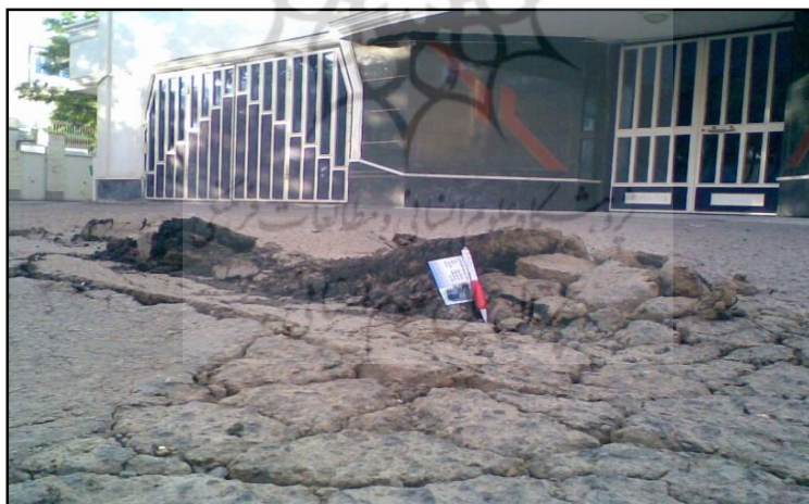
شکل ۲. زیر ساخت نادرست موجب نشست، ترک خوردگی و پیدایش چاله در آسفالت خیابانهای شهر اردبیل می‌شود. این پدیده در شهر اردبیل بسیار بارز و چشمگیر است. منبع: نگارنده، ۱۳۸۷
