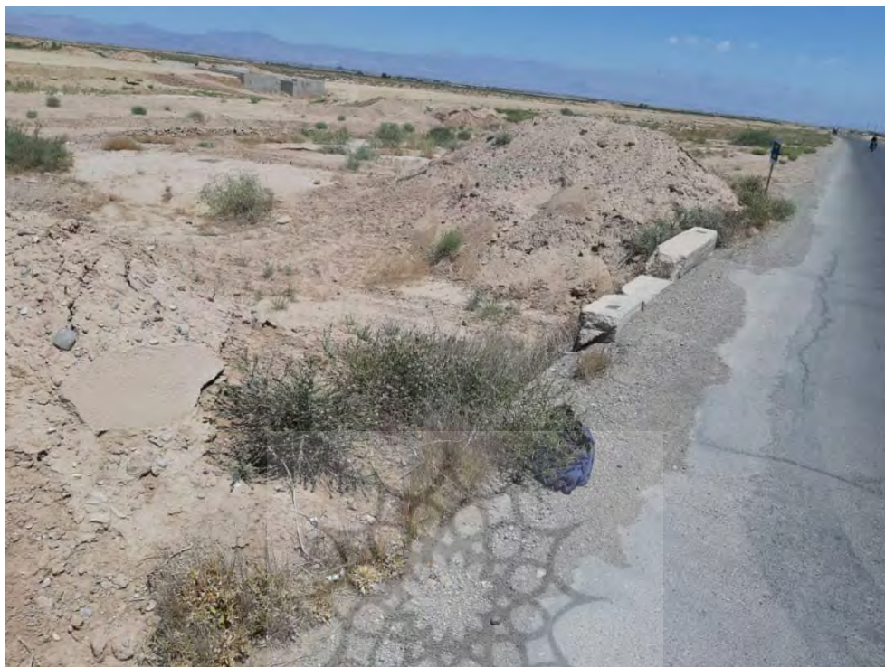
شکل ۸: نبود گاردریل یا نیوجرسی مناسب در مسیر کانال آبراهه
