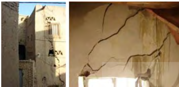
تصویر ۳- وجود ترک‌های قطری در نما و دیوارهای داخلی.
