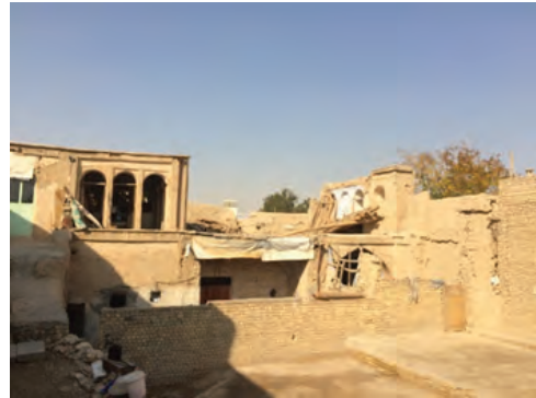
شکل شماره (۵): نمایی از ساختمان‌های فرسوده محله جویباره
