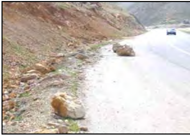
شکل ۴- ریزش ایجاد شده در اثر زلزله در مسیر جاده بروجرد به خرم آباد
