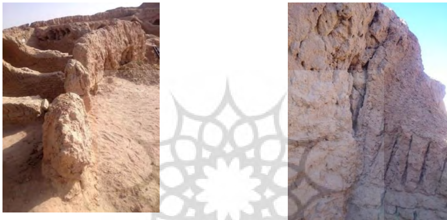
تصویر ۲۶: دیوار چینه‌ای جلوی آرامگاه‌ها، رو به حیاط (مأخذ: نگارنده). تصویر ۲۵: اتصال دیوار چینه‌ای به طاق ضربی آرامگاه (مأخذ: نگارنده).
