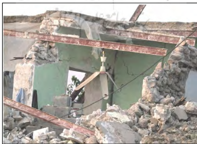
شکل ۱۶- فرو ریختن سقف بر اثر قرار گرفتن مستقیم تیرآهن بر روی دیوار
