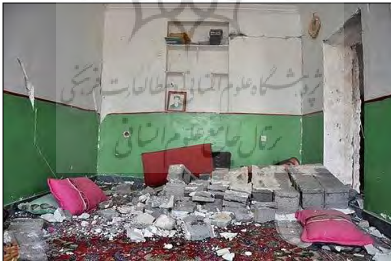
شکل ۱۲- شکست سازه‌ای برشی و عرضی دیوارها در اثر زلزله
