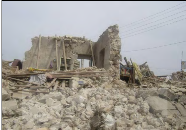
شکل ۱۷- فرو ریختن سقف بر اثر قرار گرفتن تیرهای چوبی سنگین بر روی دیوار
