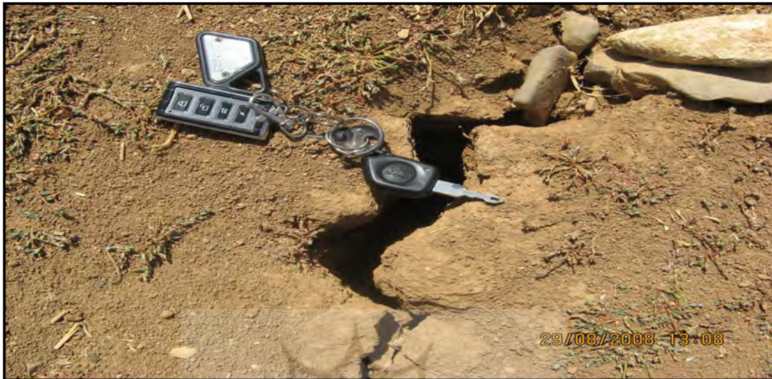
تصویر شماره ۱: درزو شکاف های موجود در کف پلپه گل زرد(دامنه کوه گاماسیاب)
